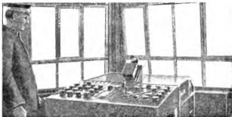
Рис. 22. Электрический стрелочный аппарат в автомате, откуда стрелки переставляются с помощью тока.
